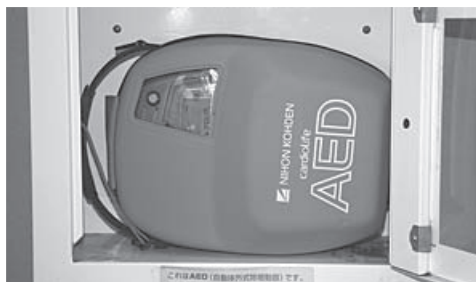
仁多庁舎、横田庁舎設置のAED
